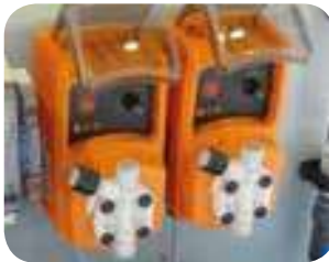
Pompe dosatrici per additivi di pre-trattamento
