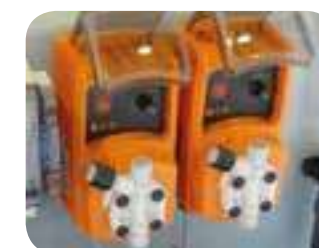
Pompe dosatrici per additivi di pretrattamento.
